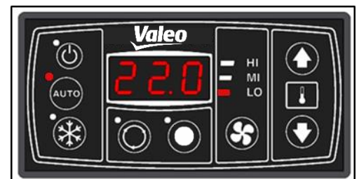
Abbildung 6 - SC410 Klimakompressor deaktiviert
