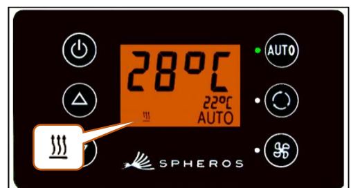
Abbildung 7 - SC600 Automodus aktiviert, Heizbetrieb
